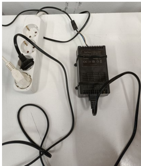
Fig. 14. Imatge del transformador principal endollat a la corrent elèctrica.
