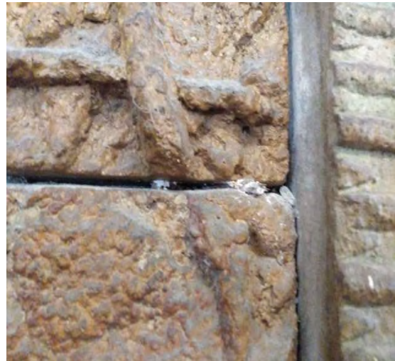
MG 15. Junt entre les peces: cinta de ciment i junt buit amb brutícia.
