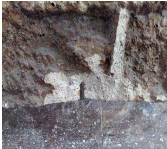
MG 14. Trencament que deixa a la vista un ganxo de subjecció de ferro rovellat
