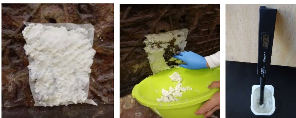
MG 26., MG 27. I MG 28 Proves de salinitat sobre les taques i regalims blancs.
