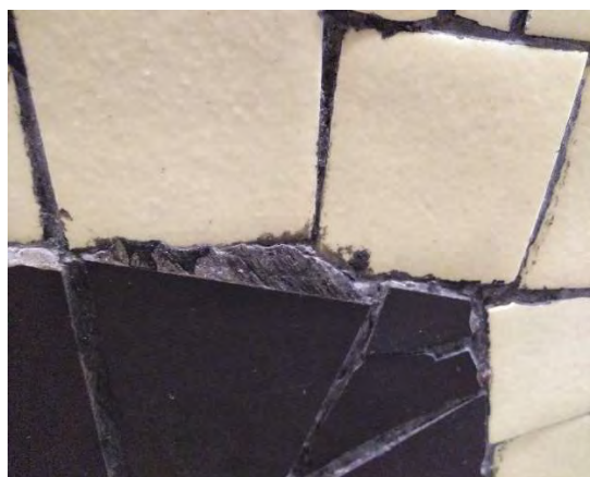
MT 16. Excés de junt, ennegrit
