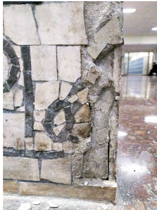
MT 28. Pèrdua de tessell·les , separació de la paret
