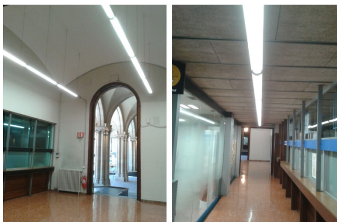
Figura 30. Il·luminació amb tubs de tecnologia LED a l'Edifici Històric. Font: Unitat d'Obres i Manteniment.
