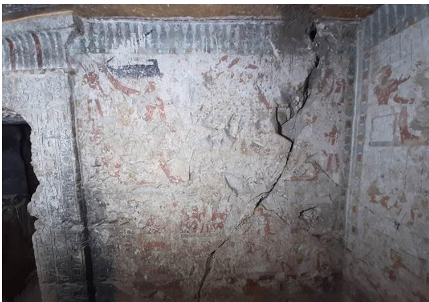
Fig. 11. Intervenciones antrópicas PA6, sala transversal, pared oeste, cuadrante norte. Embarcación y daños (raspado). ©Proyecto Amenmose
