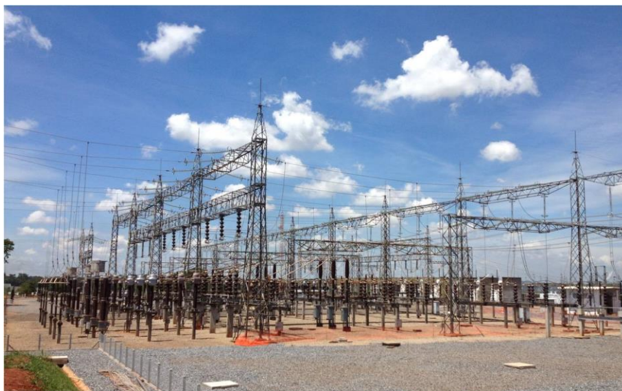
Figura 3. Subestação de Energia Elétrica Xavantes – Goiânia-GO.
