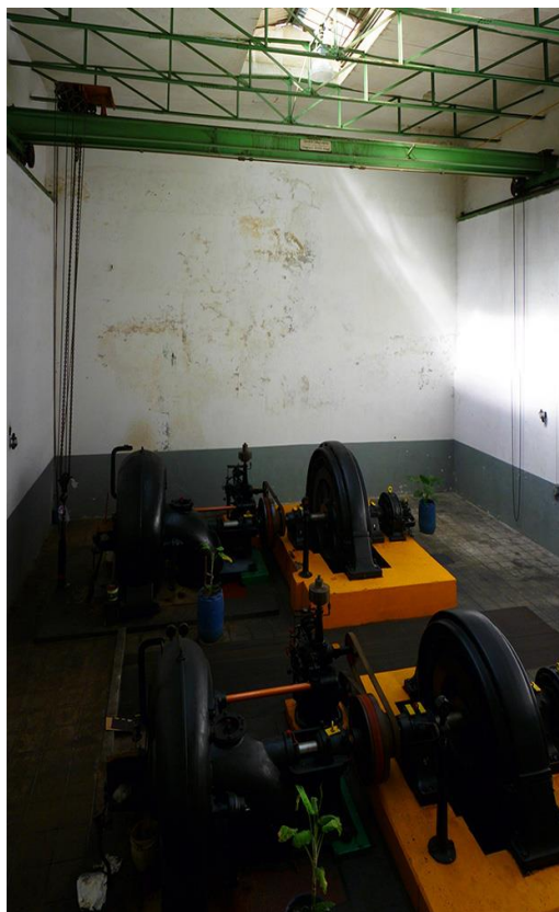
Figura 7. Planta hidroeléctrica de la fábrica La Covadonga, 2009
