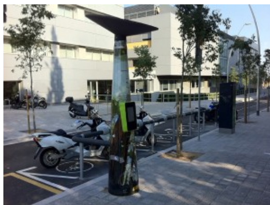
Punt de recàrrega de motos elèctriques al Campus Sud
