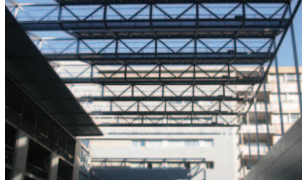
Placas fotovoltaicas de la Facultad de Física y la Facultad de Química
